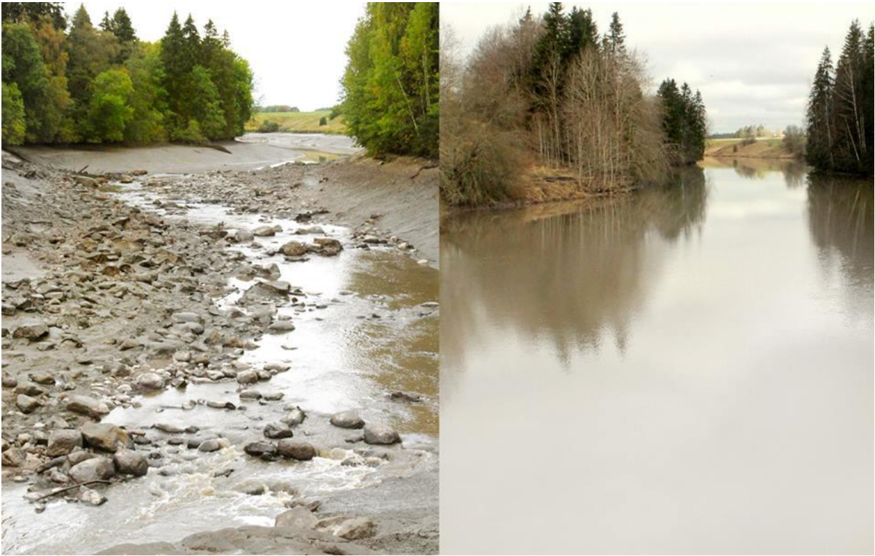
Kuva 14. Juntolan voimalaitoksen patoaltaasta paljastui koskialue patoluukkujen vaurion aikana. (Kuva: Jussi Aaltonen, Janne Tolonen)
