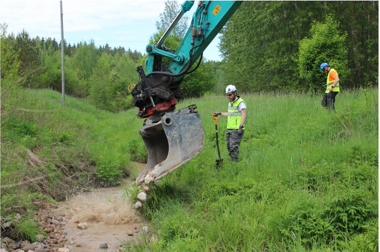
Kuva 3. Kunnostukset toteutettiin pääosin konetyönä. Kuvassa Jussi Aaltonen (Valonia) ja Olli Malmberg (TLT-Group) ohjaamassa työtä.
